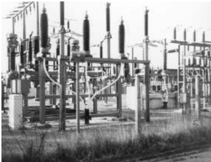
Ein Zeugnis aus vergangenen Tagen: die ehemalige Umspannstation im Wohngebiet Himmern.
