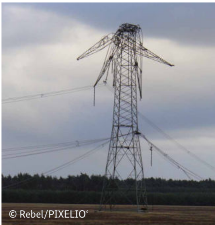
Sturmschaden durch den Orkan Kyrill im Jahr 2007
